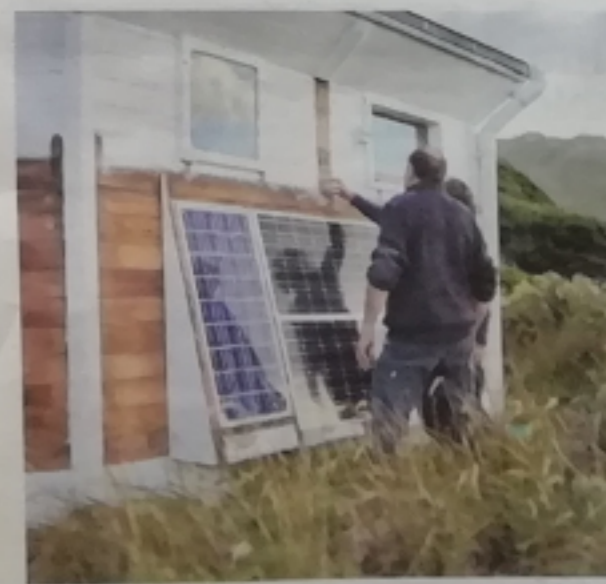
L'équipe rochelaise a remplacé les anciens panneaux solaires par deux nouveaux, plus efficaces. PHOTO ANNE PROBERT
